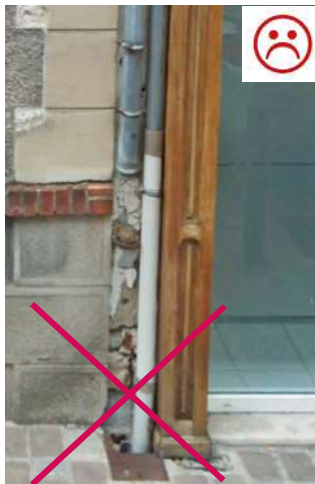
Pied de descente en PVC dont l'un manque, le PVC étant cassant.
