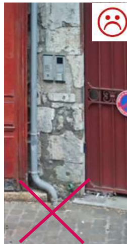
Pied de descente en zinc, sensible aux chocs.
