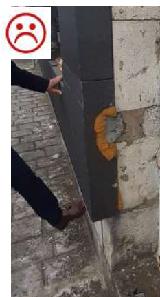
Fragilité de l'isolation extérieure
