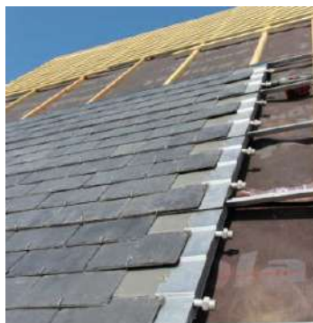
Capteurs solaires invisibles sous les ardoises. Source Cupa Pizarras.
